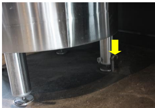
電気が貯まりやすいステンレスタンクには電気を逃がすアースが取り付けられています。全ての設備、構造にはエルヴェ独特の拘りが行き届いています
