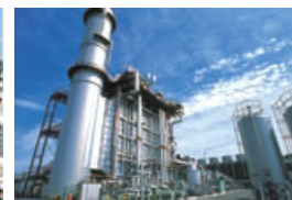
Tokyo Gas Baypower Co., Ltd.
