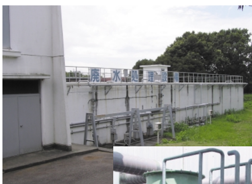
フジヤマ工場廃水処理設備
