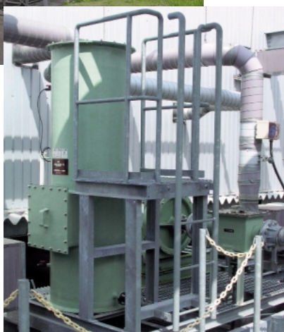
筑波研究所 固液分離槽脱臭設備
