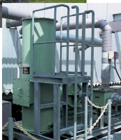
筑波研究所 固液分離槽脱臭設備
