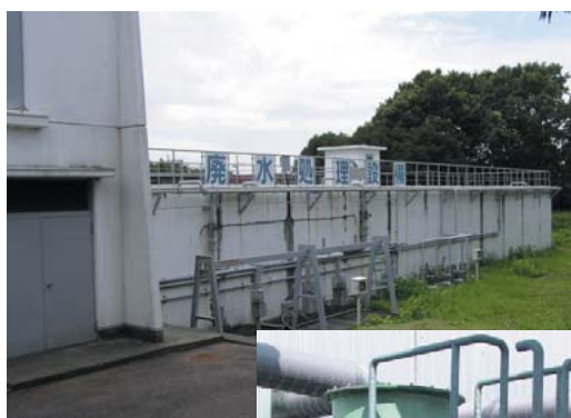
フジヤマ工場廃水処理設備
