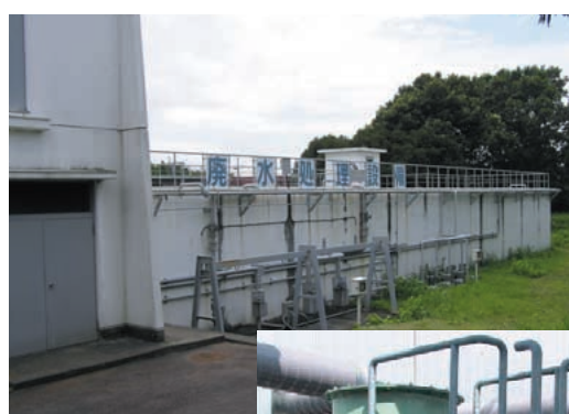
フジヤマ工場廃水処理設備
