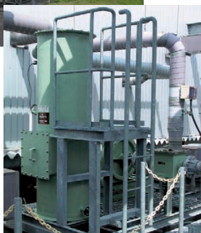
筑波研究所 固液分離槽脱臭設備
