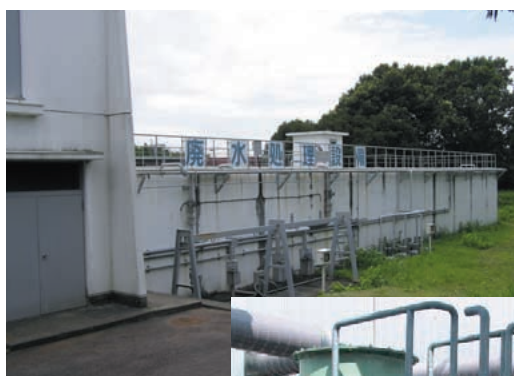
フジヤマ工場廃水処理設備
