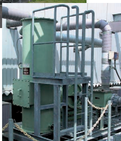
筑波研究所 固液分離槽脱臭設備
