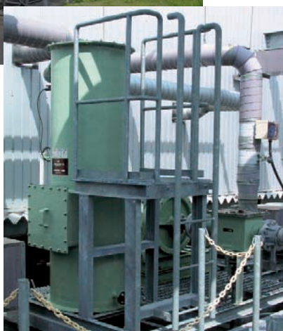
筑波研究所 固液分離槽脱臭設備
