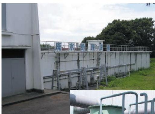
フジヤマ工場廃水処理設備
