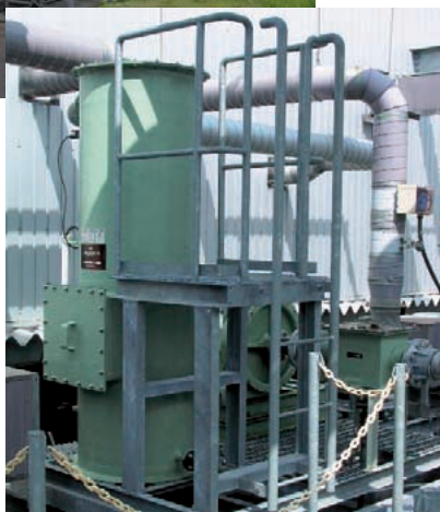
筑波研究所 固液分離槽脱臭設備
