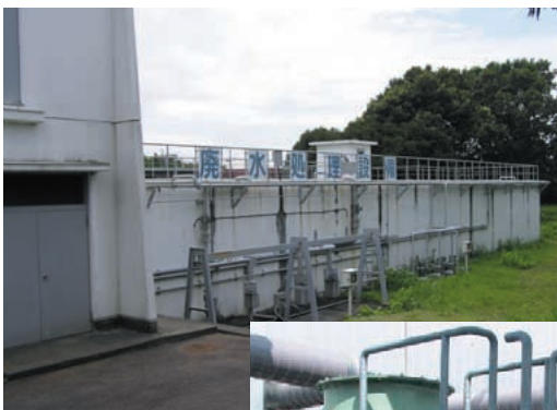
フジヤマ工場廃水処理設備
