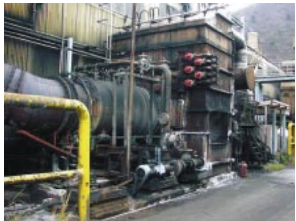
排煙脱硫装置
