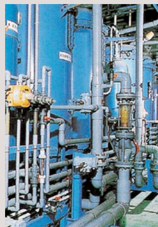
排水処理設備
