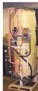
エコキュート配管
