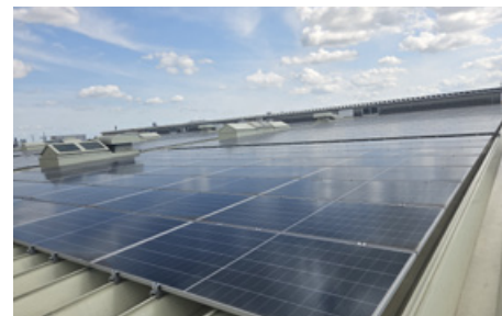
千葉工場で稼働した太陽光発電設備
