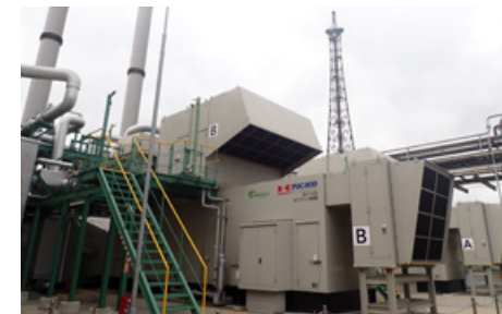
2022年に運転を開始した千葉工場のガスタービン発電設備
