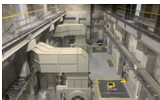
新青海川発電所（所内）
