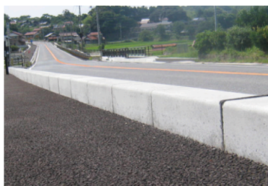
道路境界ブロック
