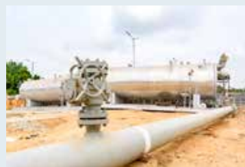
Axxelaグループが操業しているパイプライン
