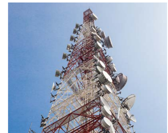
ミャンマーの通信塔
