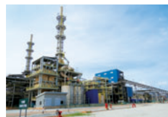
ライナス社 マレーシア工場 排ガス処理プラント
