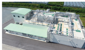
九州工場 新排水処理場
