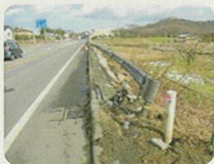
ガードレール・ 標識等の損傷
