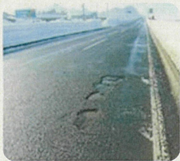
路面の穴ぼこ・ 段差
