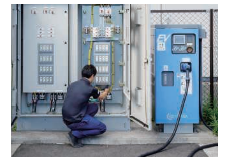
いちご笠岡拓海町ECO発電所の緊急用充電所
