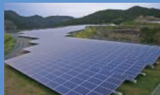
いちご都城安久町 ECO発電所
