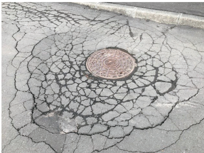
凍結膨張によって舗装が損傷したマンホール周辺
