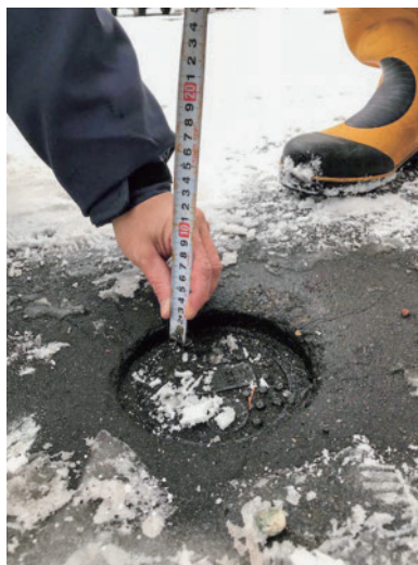
水道管の仕切弁筐に生じた段差を計測
