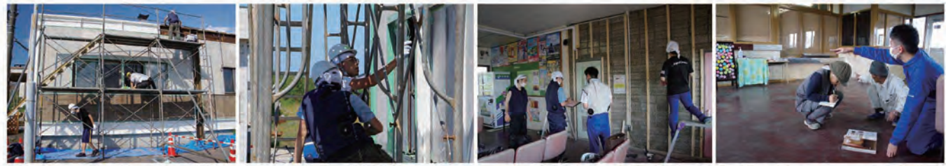
[3巡目] 外観鉄骨部の下地塗装後に着色 既存の壁を隠す下地の製作 タイル業者さんと打合せ
