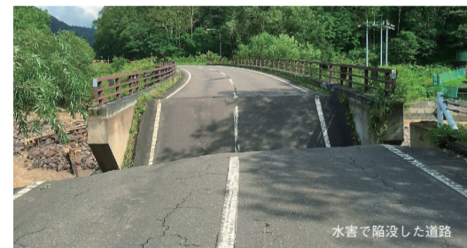
水害で陥没した道路
