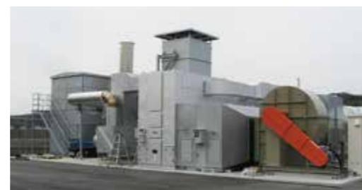
VOC廃ガス処理装置
