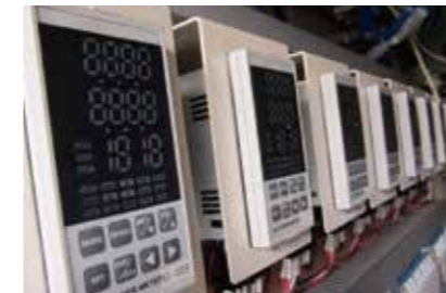
デマンド監視装置
