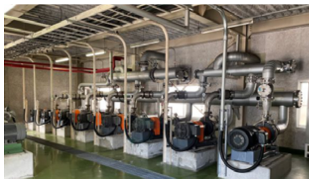
水処理設備(名古屋工場)
