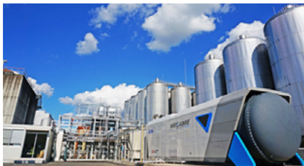
バイオメタンガス燃料電池発電システム
