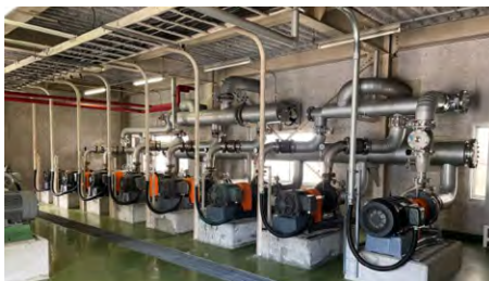
水処理設備(名古屋工場)
