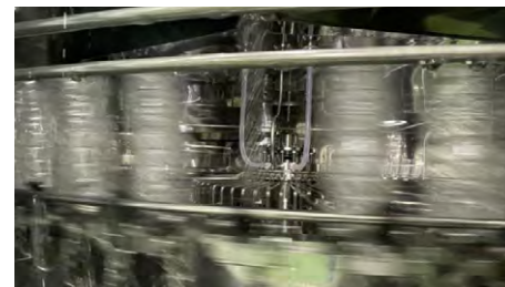
水の回収設備、殺菌洗浄設備(明石工場)
