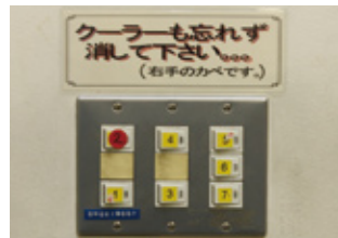
照明スイッチの上にエアコンの注意喚起も
