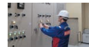
↑ 受変電設備の点検
