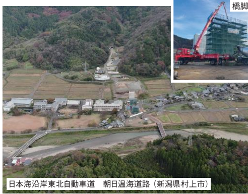
高速かつ安定した輸送ルートを確認することで物流の効率化により、地域活性化を支援
