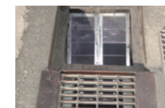
ペレット捕集用スクリーン設置例 (雨水枦)
